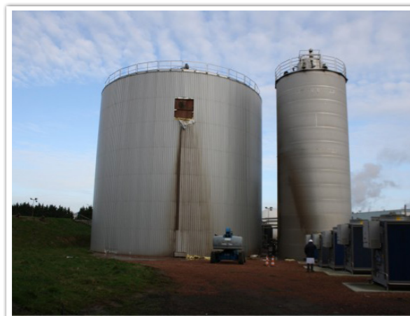
Fuite sur un digesteur © DREAL Hauts-de-France
